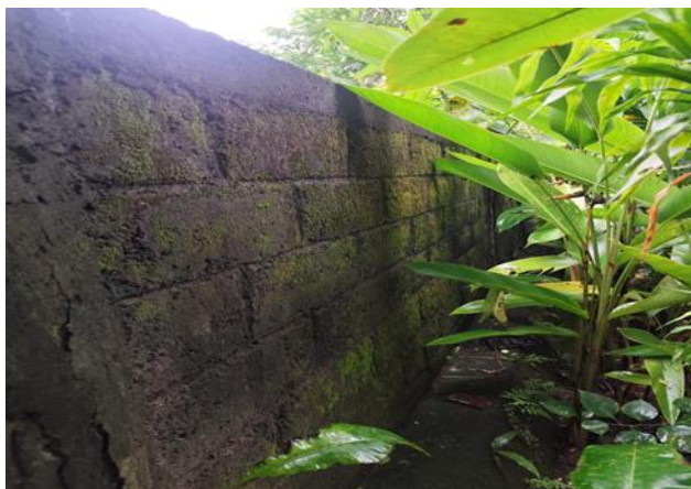
Gambar 5. Kondisi Tembok Pembatas di PT Bali Agung Sesari
